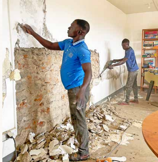
Wasserschaden an der Wand in einem der Stationshäuser
